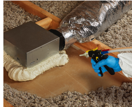
Conduit au grenier
